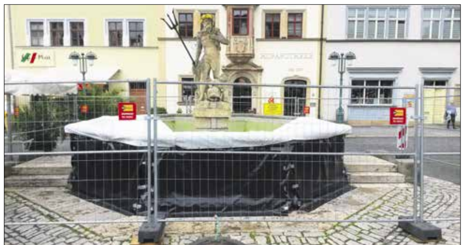
Der Neptunbrunnen ist derzeit am Sockel mit schwarzer Folie verkleidet. Die dahinter befindlichen Kompressen dienen der Salzreduzierung im Stein.
