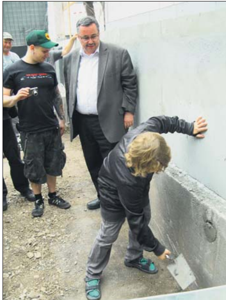
OB Stefan Wolf mauert gemeinsam mit Schöndorfer Kindern die mit einer Tageszeitung und einer Münze gefüllte Zeitkapel in das Fundament des Neubaus.
